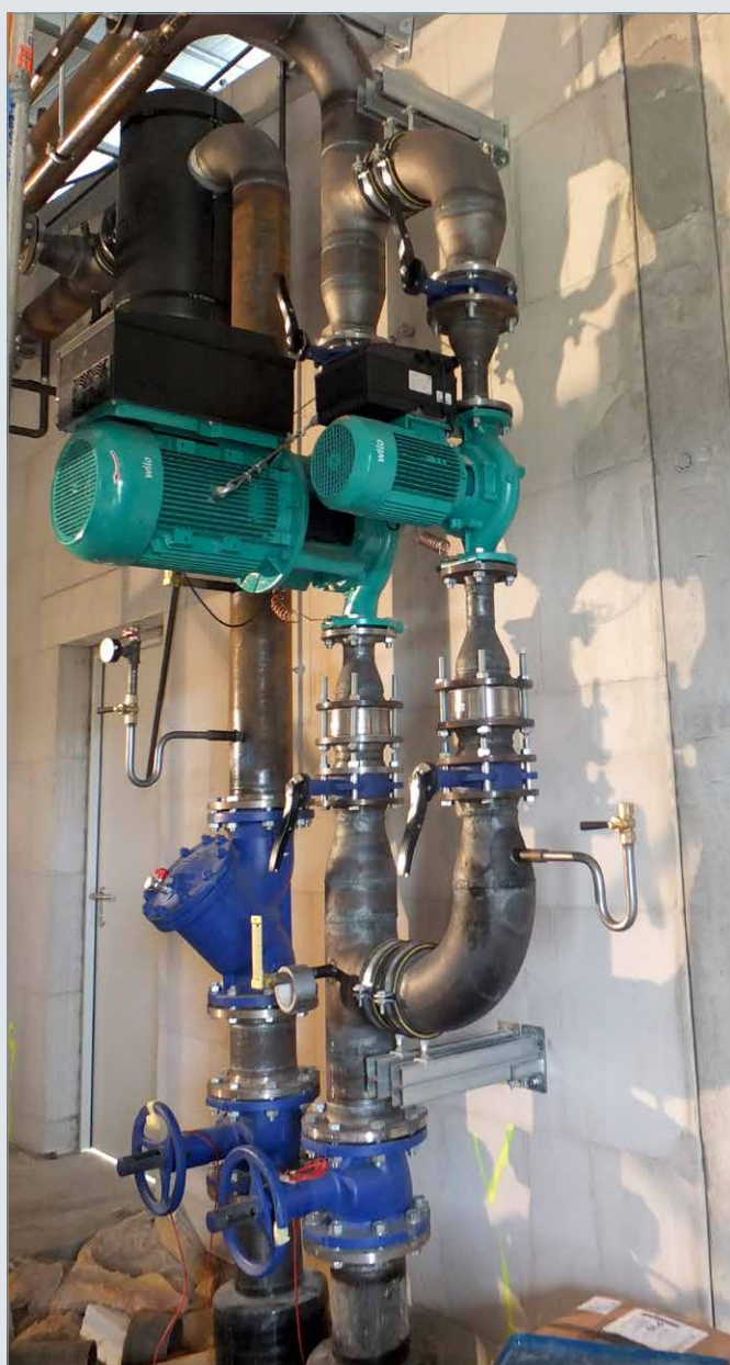
Doppelpumpen zur Förderung der Wärmeenergie in das Nahwärmenetz
