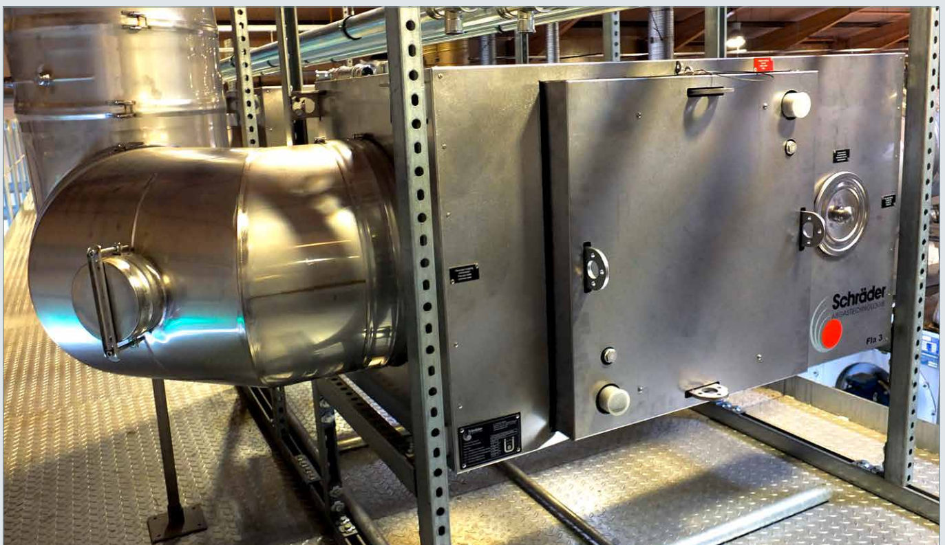
Wärmetauscher mit primärseitiger Zuführung der Abwärme
